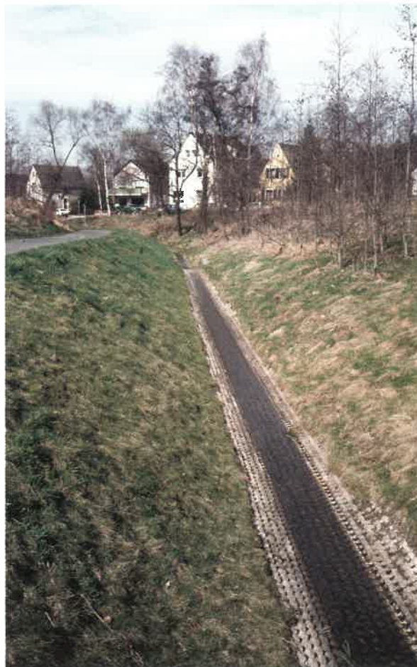
IV-30: Negativbeispiel für einen Grabenausbau
